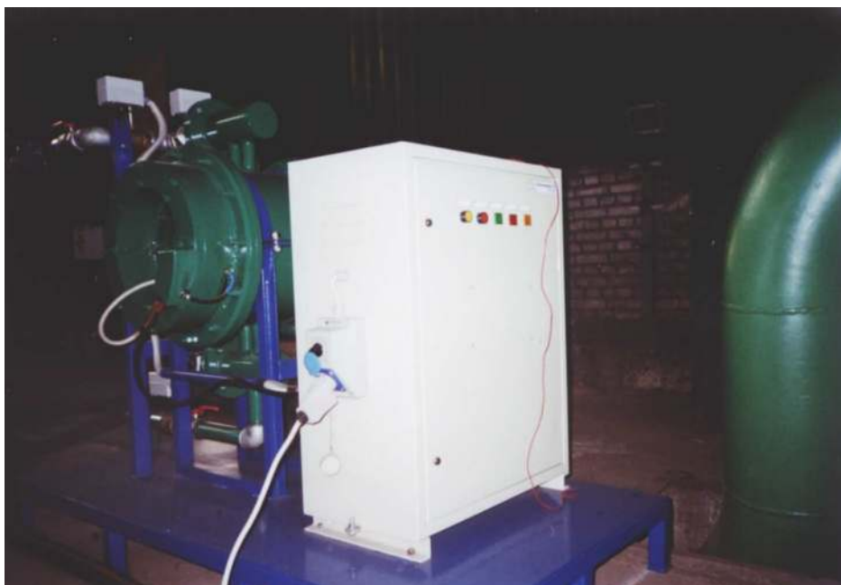
Ogólny widok filtra elektromagnetycznego FM-20A, o wydajności 20\text{m}^3/\text{h} , zamontowanego w pompowni głównej Huty Zawiercie
